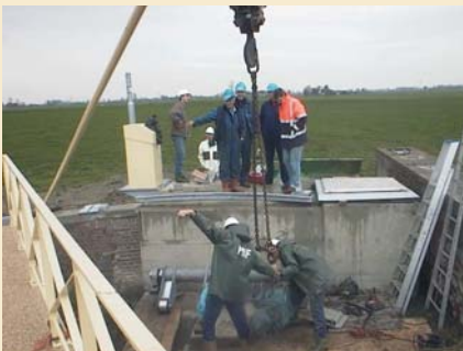
montage van het opzetwerk. Het opzetwerk zorgt ervoor dat de brug draait en kantelt.
